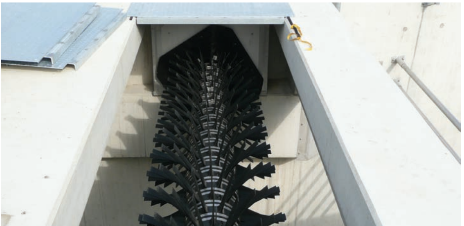
Die Belüfterwalze im Nitrifikationsbecken (9)
