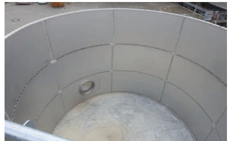
(19) Der Prozesswasserspeicher in leerem Zustand
