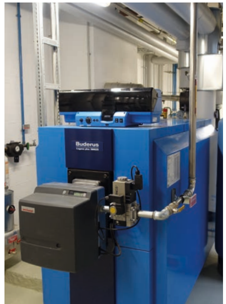
Brenner der neuen Heizung
