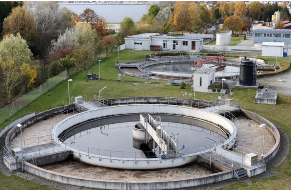
Das hintere umlaufende Becken ist das Denitrifikationsbecken (8) das vordere das Nitrifikationsbecken (9). Rechts im Bild der schwarze Tank der Phosphatfällstation (10).
