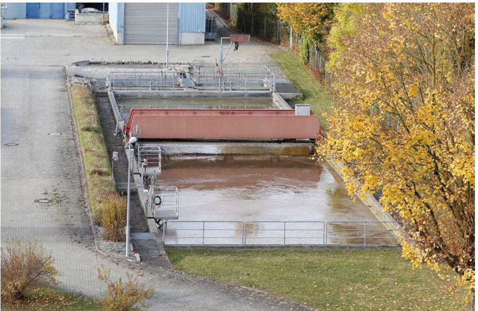
Das anaerobe Mischbecken (7) mit dem Vorklärbecken (6)
