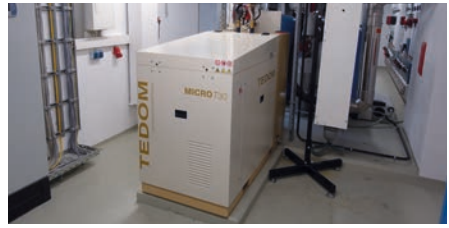
Das neue Blockheizkraftwerk
