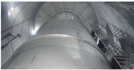
Der Faulturm der Hochlastfaulung von innen
