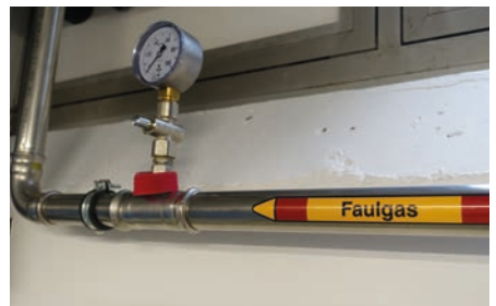
Faugasleitung zum BHKW
