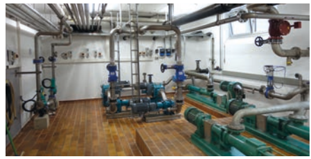
Pumpenkeller in der Kläranlage, Stand 2017
