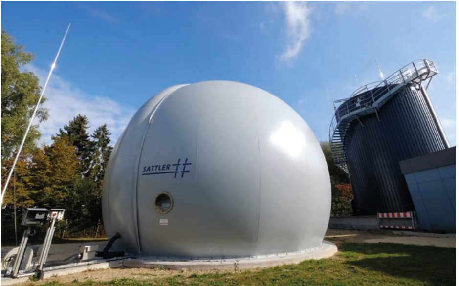
[15] Die Hochlastfaulanlage von außen
