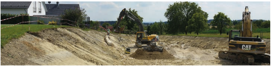
Regenüberlaufbecken im Neubaugebiet Hafenäcker. Ringingen 2015
