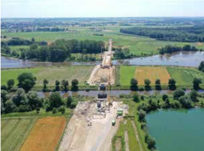
Abbildung 22: Brückenbauwerke über den Donaukanal, Blick in Richtung Dellmensingen (Quelle: Süleymann Tillem, RP Tübingen)
