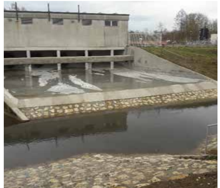
Abbildung 24: neues Auslaufgerinne am Hochwasserpumpwerk der Kläranlage
